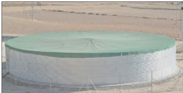
Detalle depósito metálico con techo de lona antialgas.
